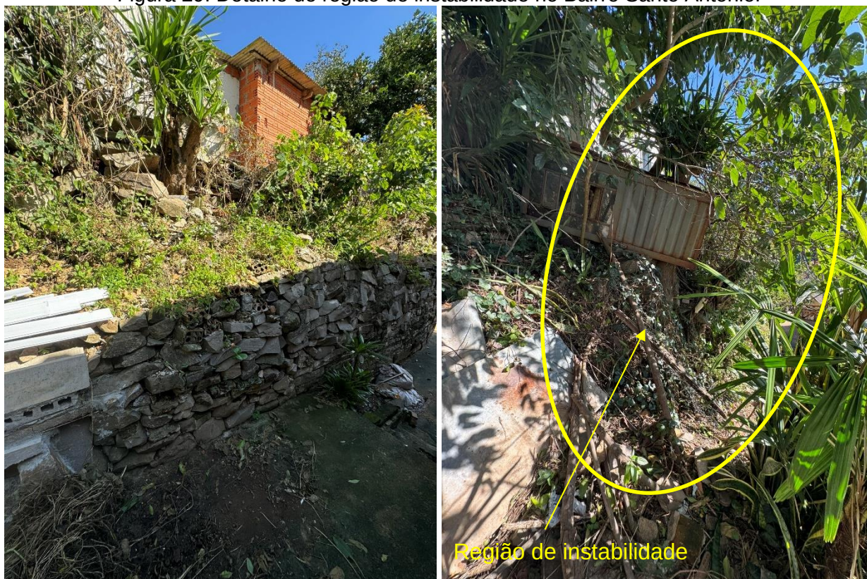
Figura 29: Detalhe de região de instabilidade no Bairro Santo Antônio.
