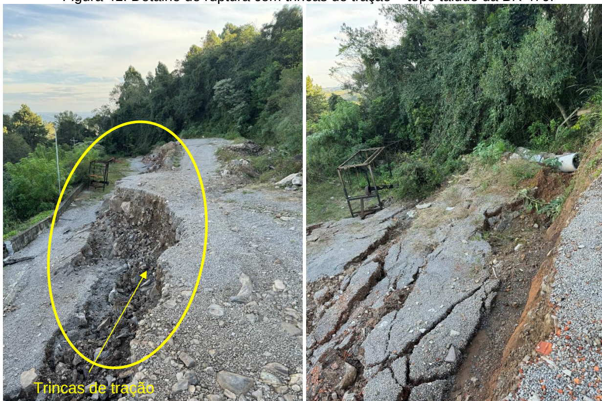
Figura 41: Detalhe de ruptura com trincas de tração – topo talude da BR 470.
