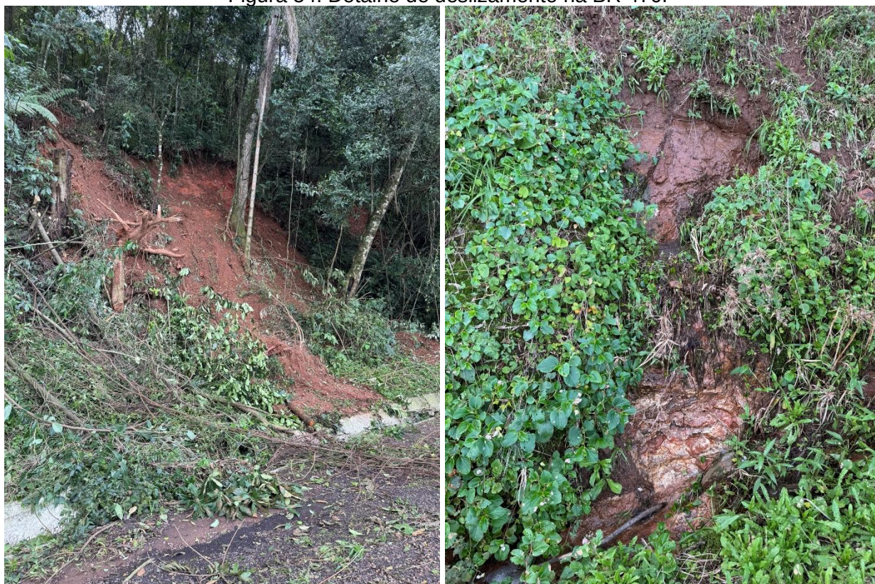
Figura 54: Detalhe de deslizamento na BR 470.
