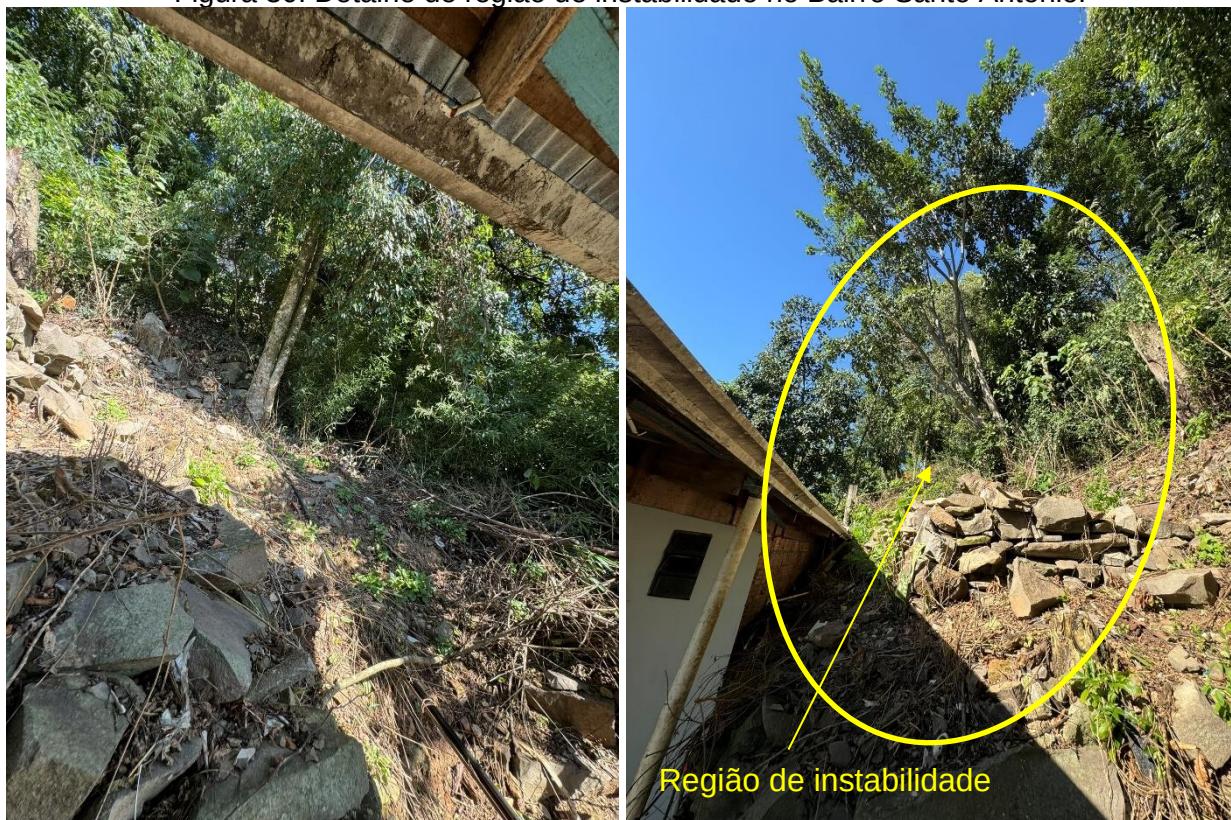
Figura 30: Detalhe de região de instabilidade no Bairro Santo Antônio.
