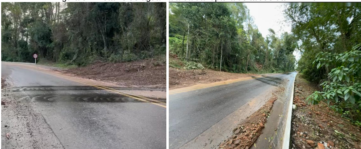
Figura 51: Detalhe de água na área da ruptura do talude da BR 470.
