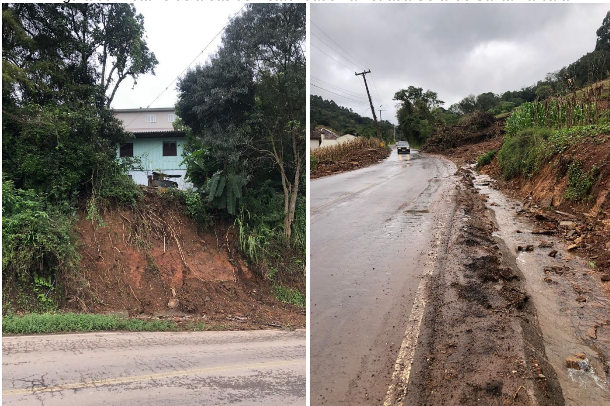
Figura 60: Detalhe de áreas de instabilidade na Estrada Geral de Santa Bárbara.
