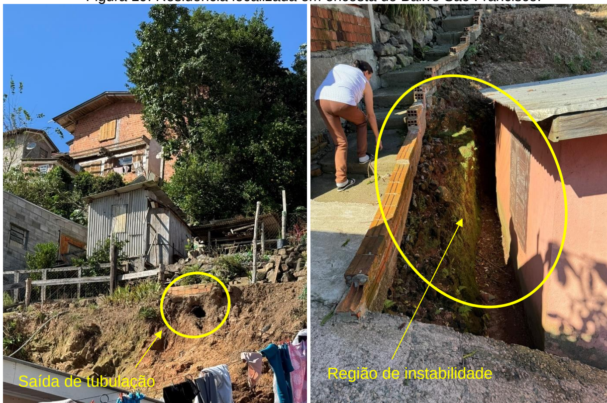
Figura 19: Residência localizada em encosta do Bairro São Francisco.
