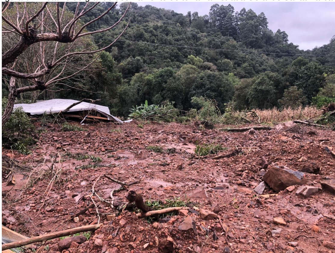
Figura 62: Detalhe de grande deslizamento de terra na Estrada Geral de Santa Bárbara.
