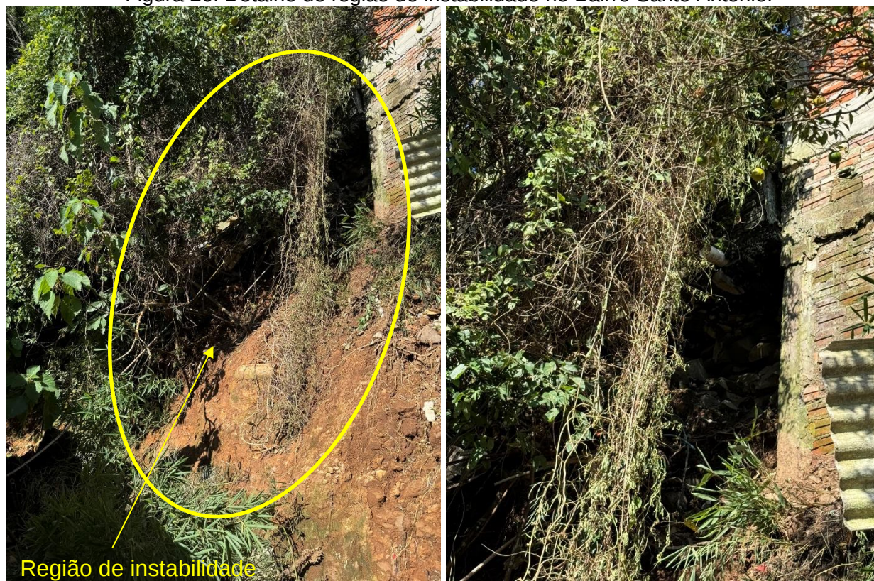
Figura 26: Detalhe de região de instabilidade no Bairro Santo Antônio.
