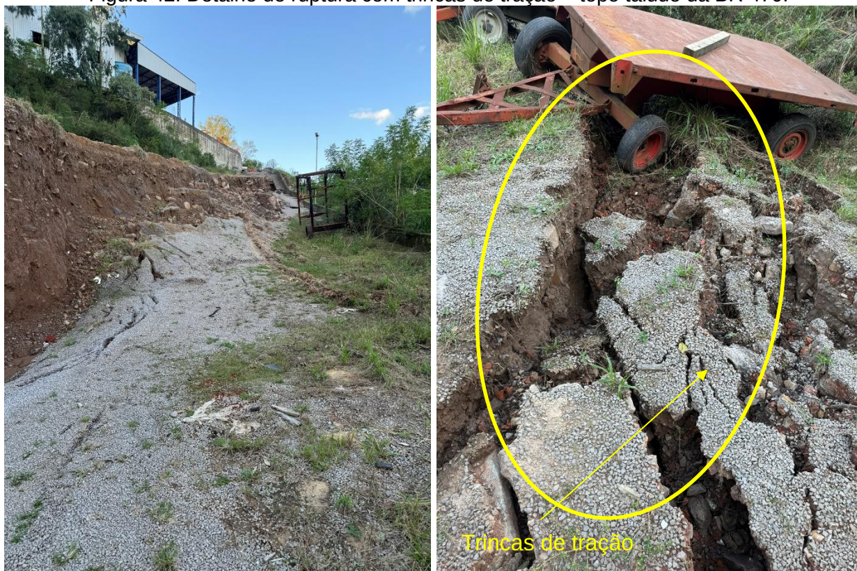
Figura 42: Detalhe de ruptura com trincas de tração – topo talude da BR 470.
