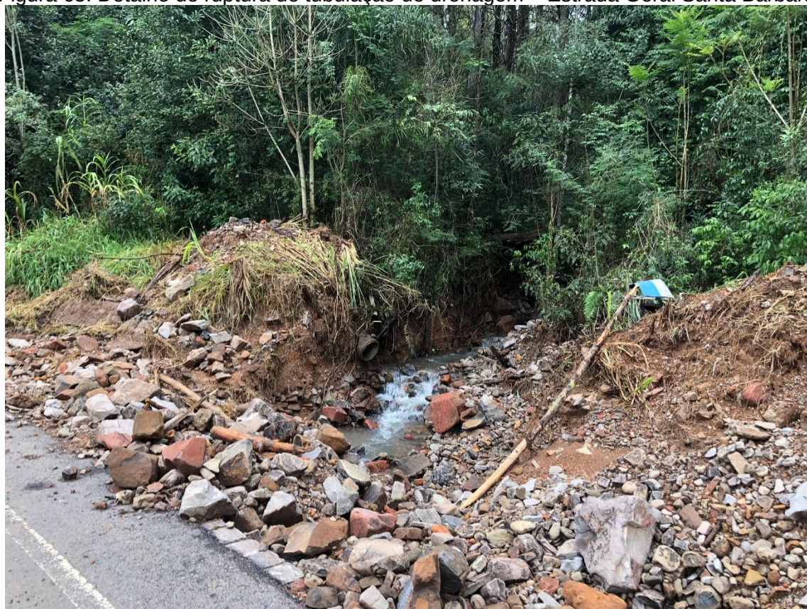
Figura 65: Detalhe de ruptura de tubulação de drenagem – Estrada Geral Santa Bárbara.
