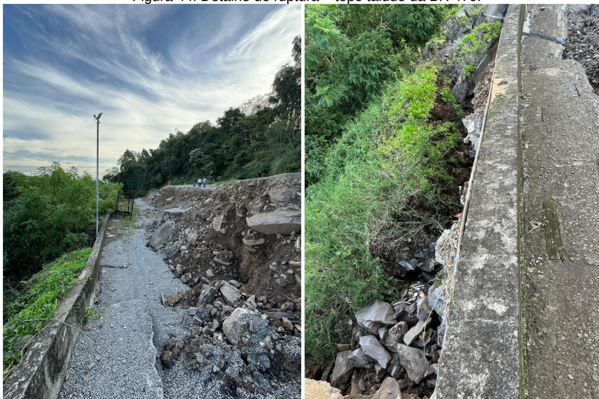
Figura 44: Detalhe de ruptura – topo talude da BR 470.
