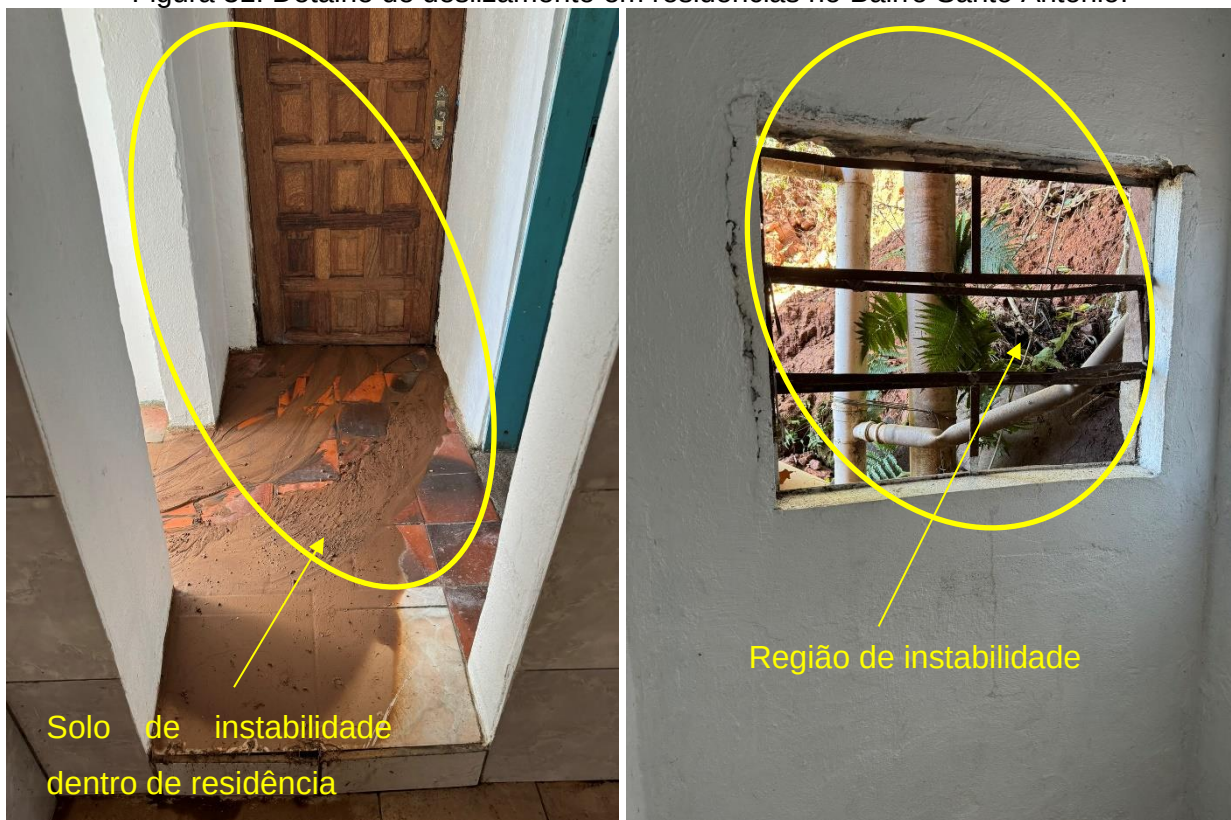
Figura 31: Detalhe de deslizamento em residências no Bairro Santo Antônio.
