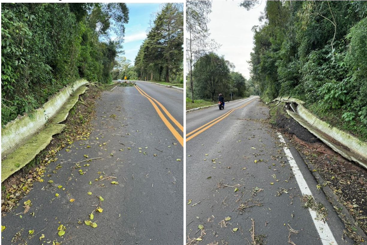
Figura 52: Detalhe de deslizamento na BR 470 e modificação na pista.
