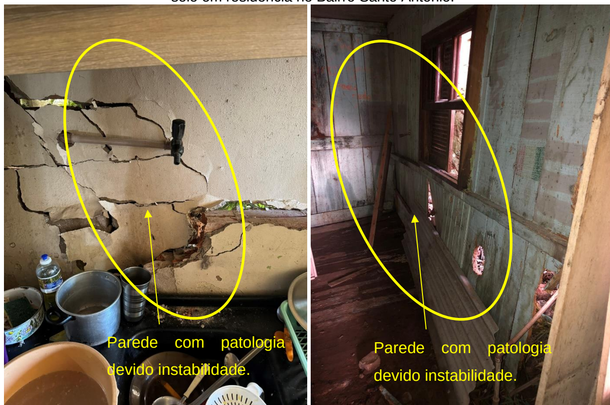
Figura 24: Detalhe de parede deslocada com registro de patologia devido a deslizamento de solo em residência no Bairro Santo Antônio.
