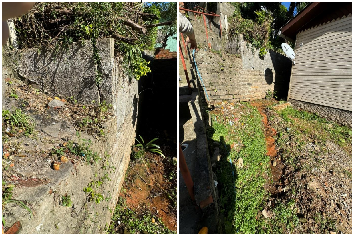
Figura 35: Detalhe de residências em encostas com presença de água na base de muro de contenção no Bairro Santo Antônio.
