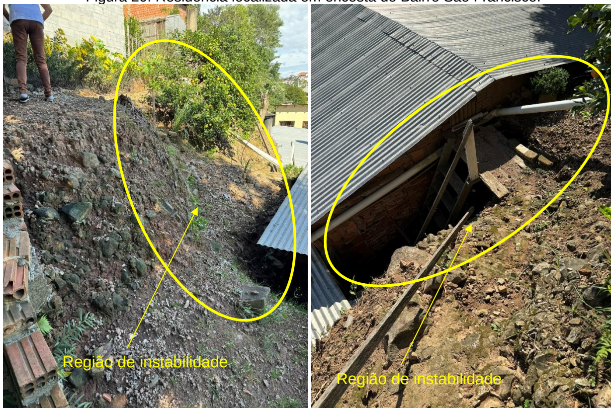
Figura 20: Residência localizada em encosta do Bairro São Francisco.
