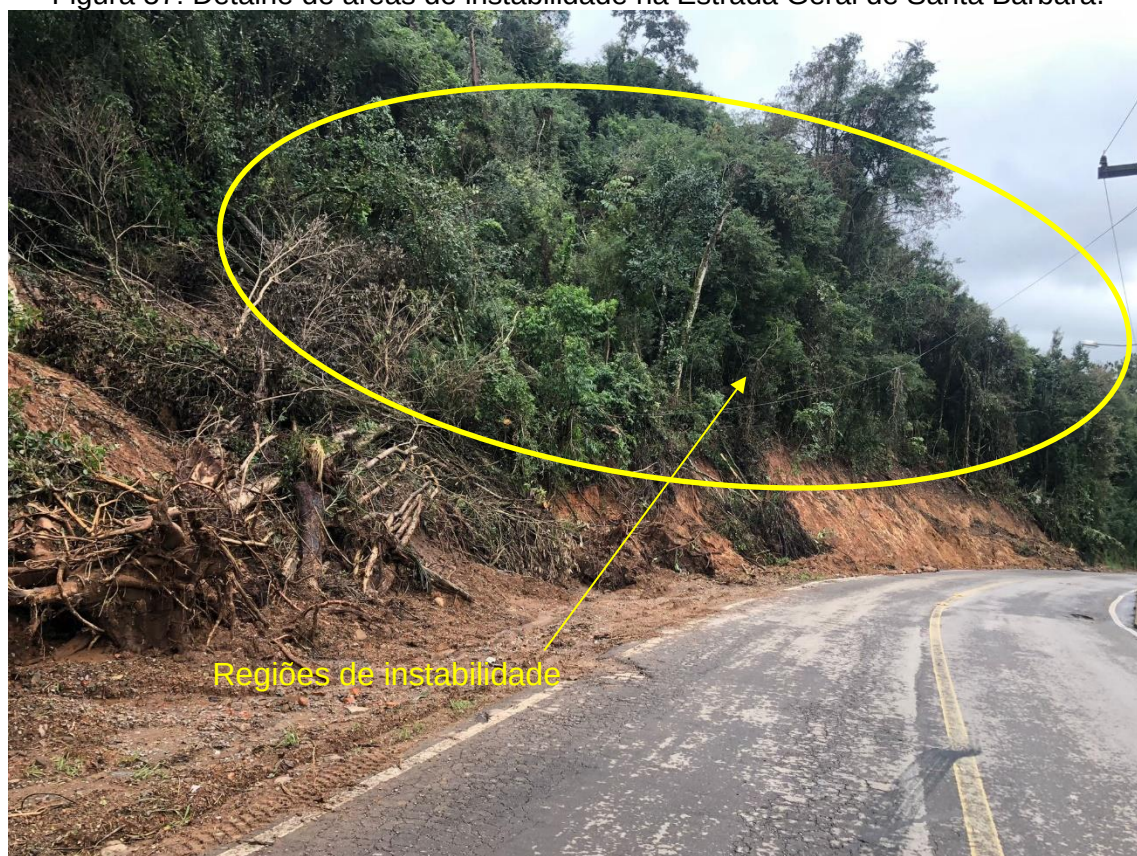
Figura 57: Detalhe de áreas de instabilidade na Estrada Geral de Santa Bárbara.
