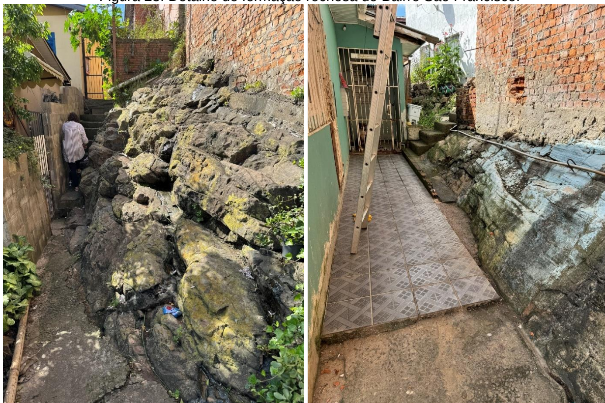
Figura 23: Detalhe de formação rochosa do Bairro São Francisco.
