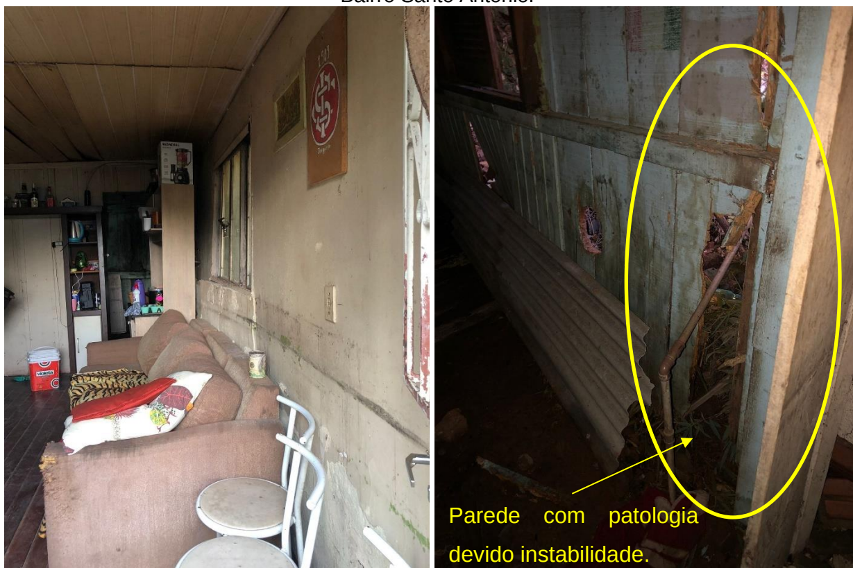
Figura 25: Detalhe de patologia em parede de devido a deslizamento de solo em residência no Bairro Santo Antônio.
