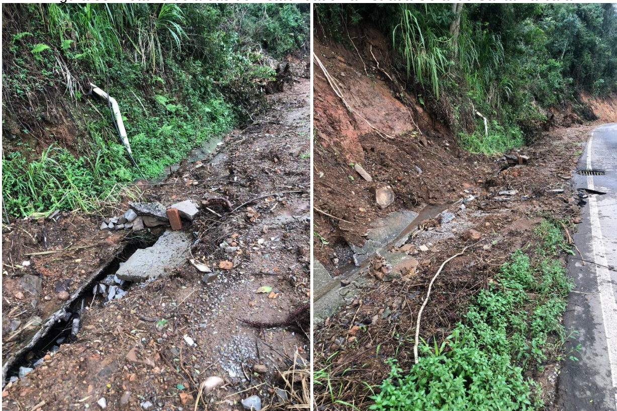
Figura 58: Detalhe de áreas de instabilidade na Estrada Geral de Santa Bárbara.
