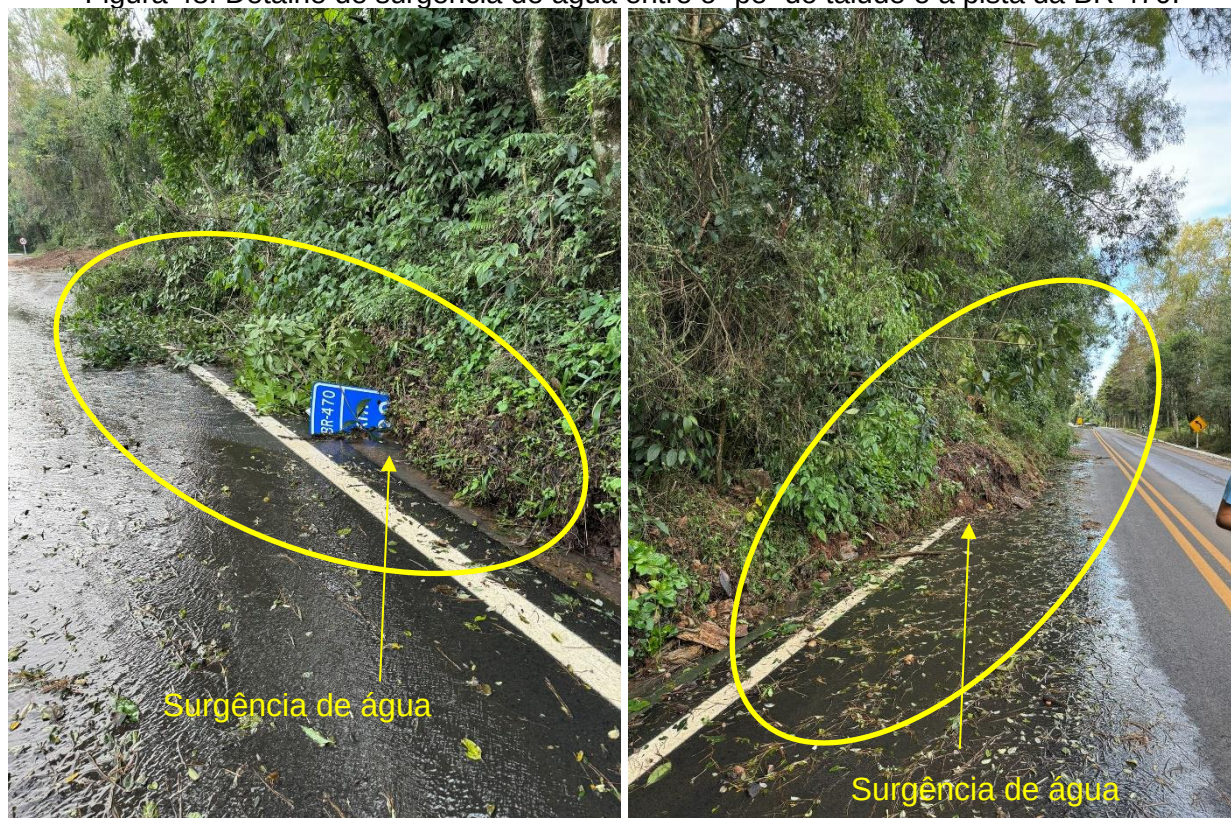
Figura 48: Detalhe de surgência de água entre o “pé” do talude e a pista da BR 470.
