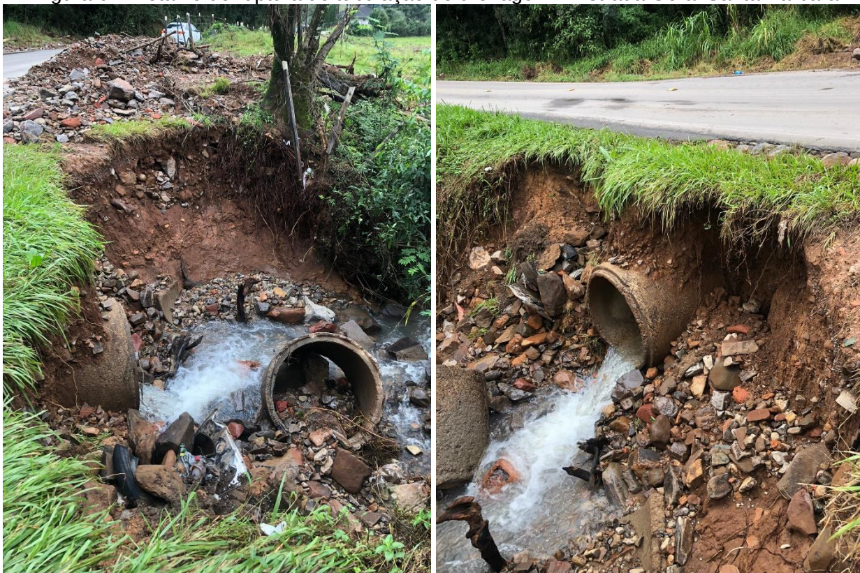
Figura 64: Detalhe de ruptura de tubulação de drenagem – Estrada Geral Santa Bárbara.
