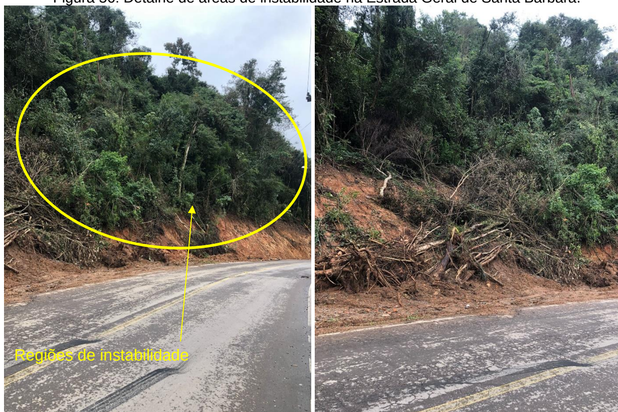
Figura 56: Detalhe de áreas de instabilidade na Estrada Geral de Santa Bárbara.
