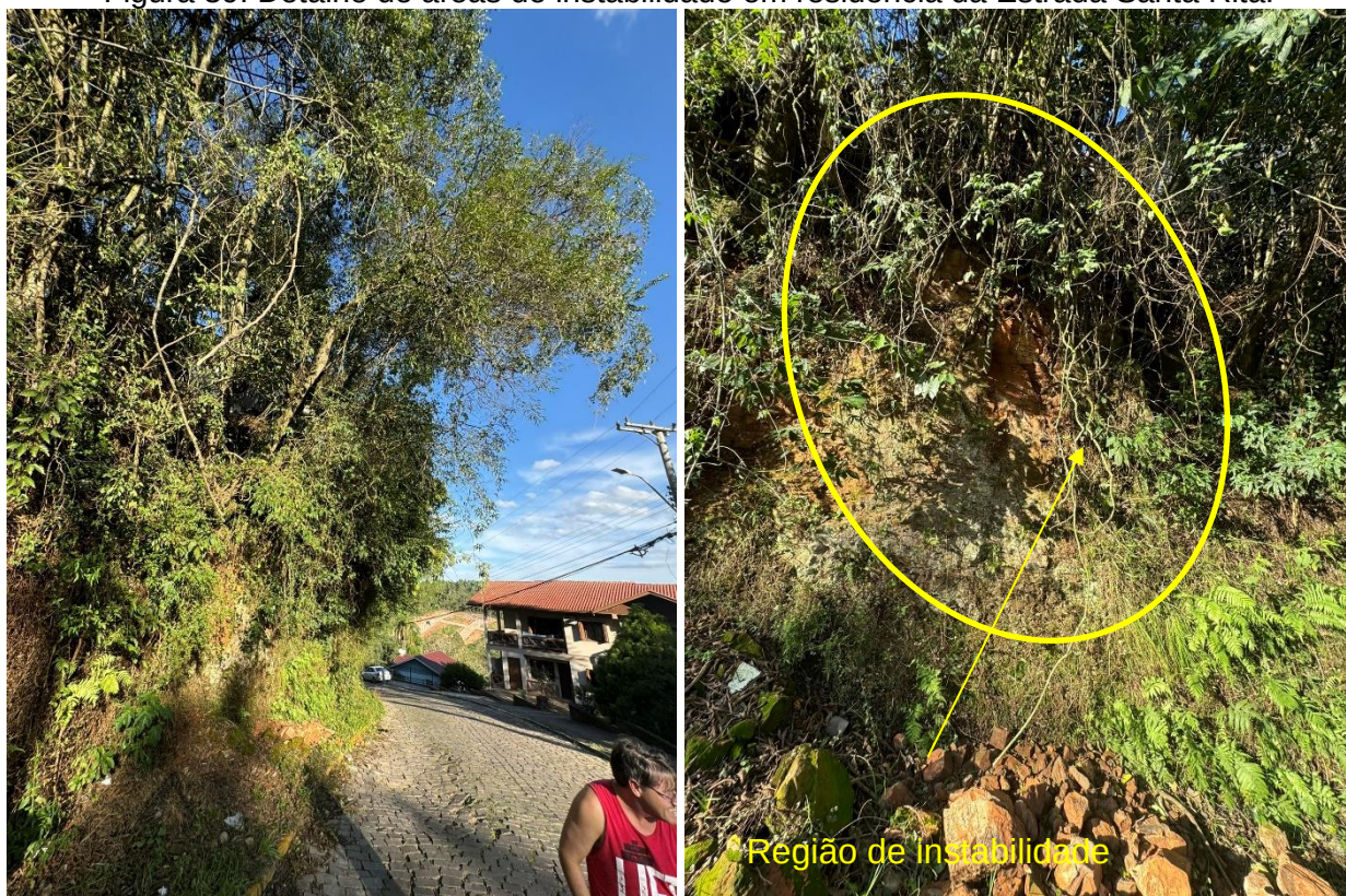
Figura 39: Detalhe de áreas de instabilidade em residência da Estrada Santa Rita.
