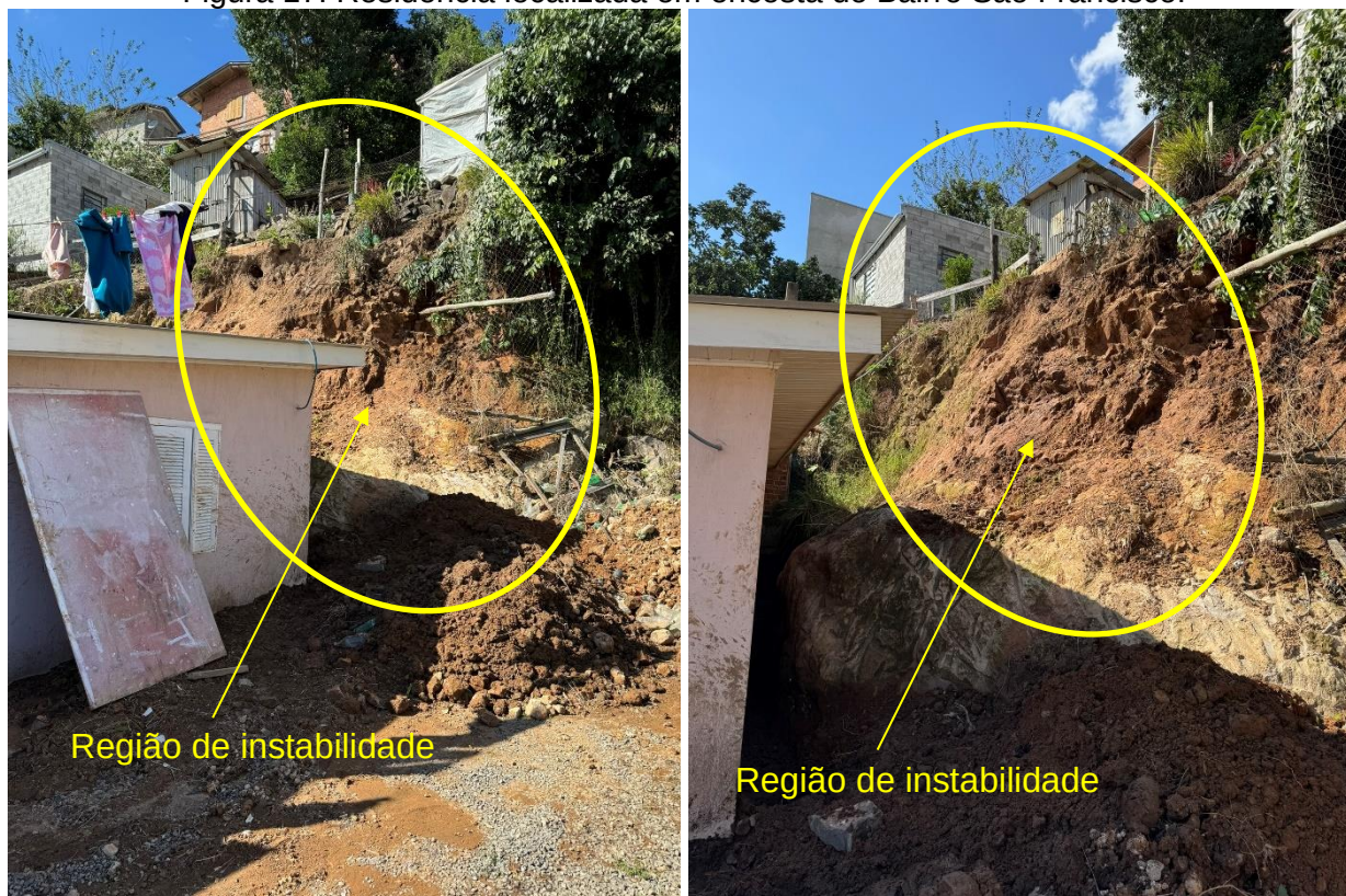
Figura 17: Residência localizada em encosta do Bairro São Francisco.
