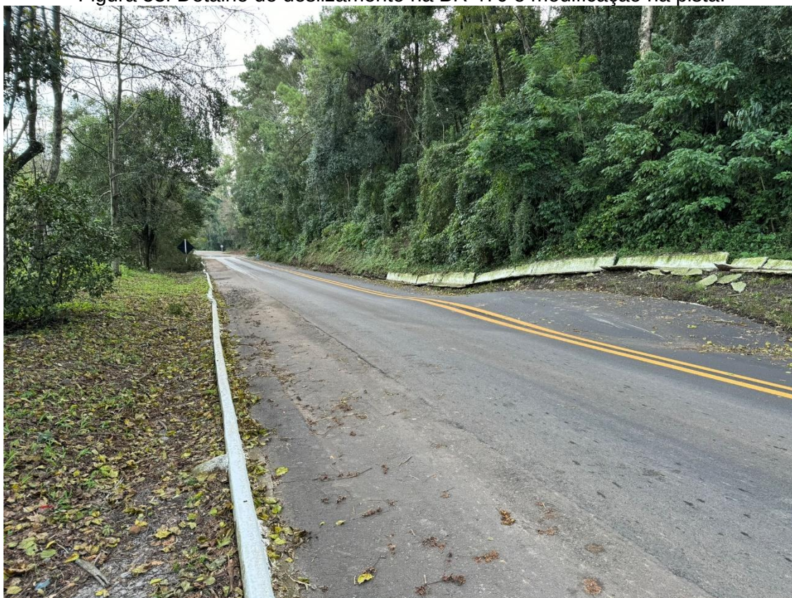
Figura 53: Detalhe de deslizamento na BR 470 e modificação na pista.
