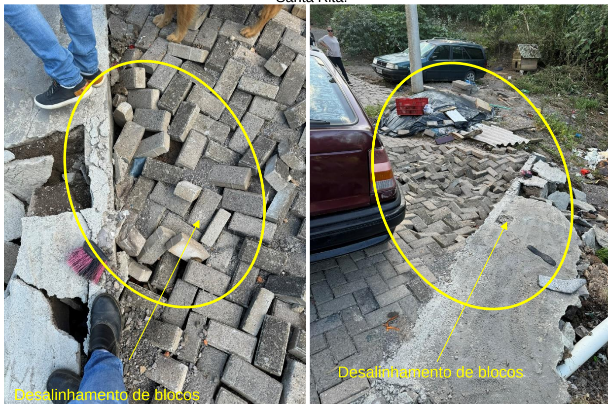
Figura 38: Detalhe desalinhamento de blocos devido a fluxo superficial de água na Estrada Santa Rita.
