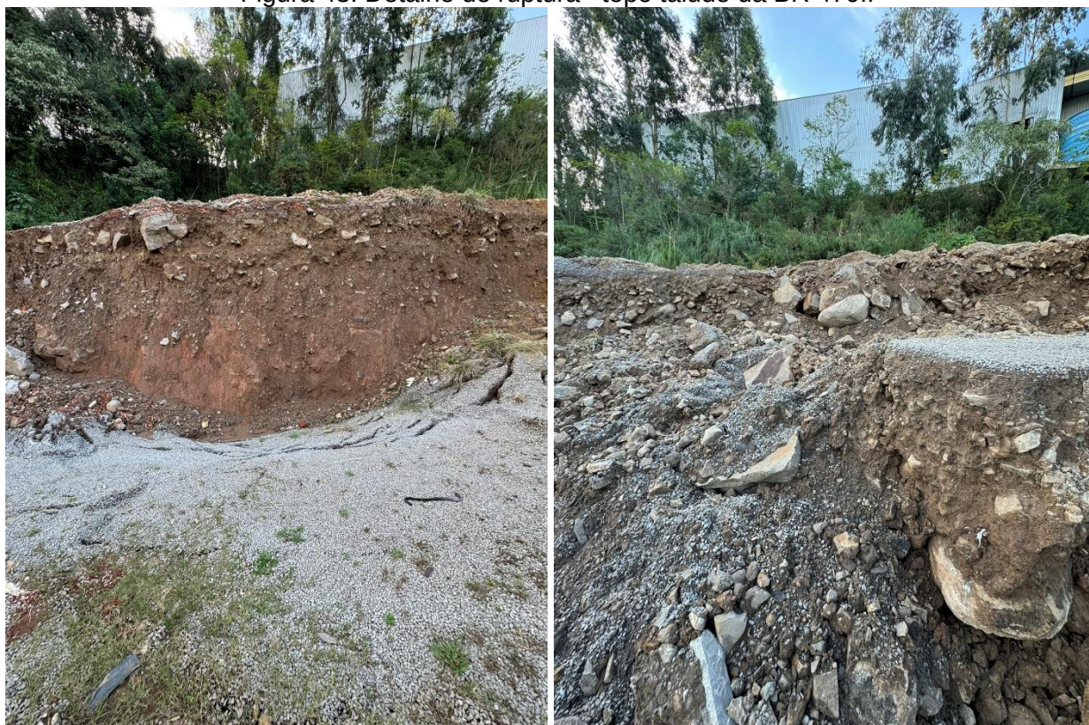
Figura 43: Detalhe de ruptura– topo talude da BR 470..
