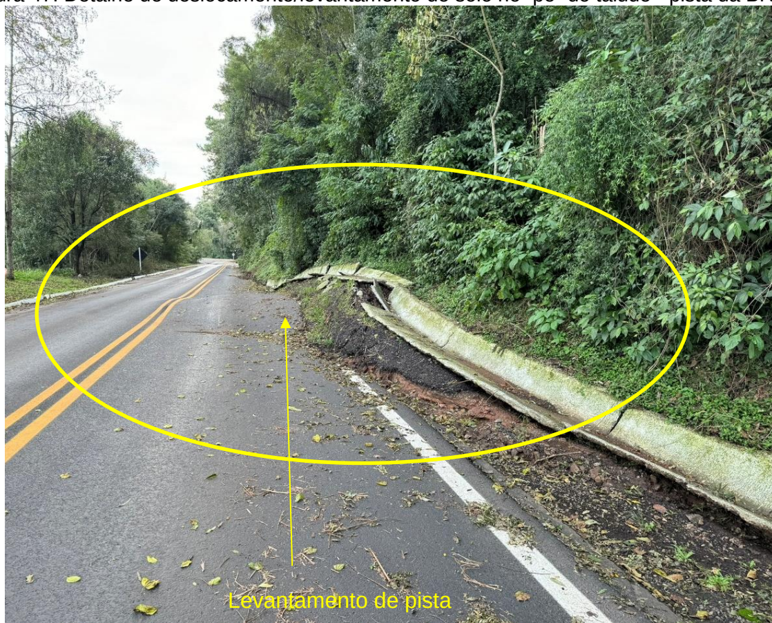
Figura 47: Detalhe de deslocamento/levantamento de solo no “pé” do talude - pista da BR 470.
