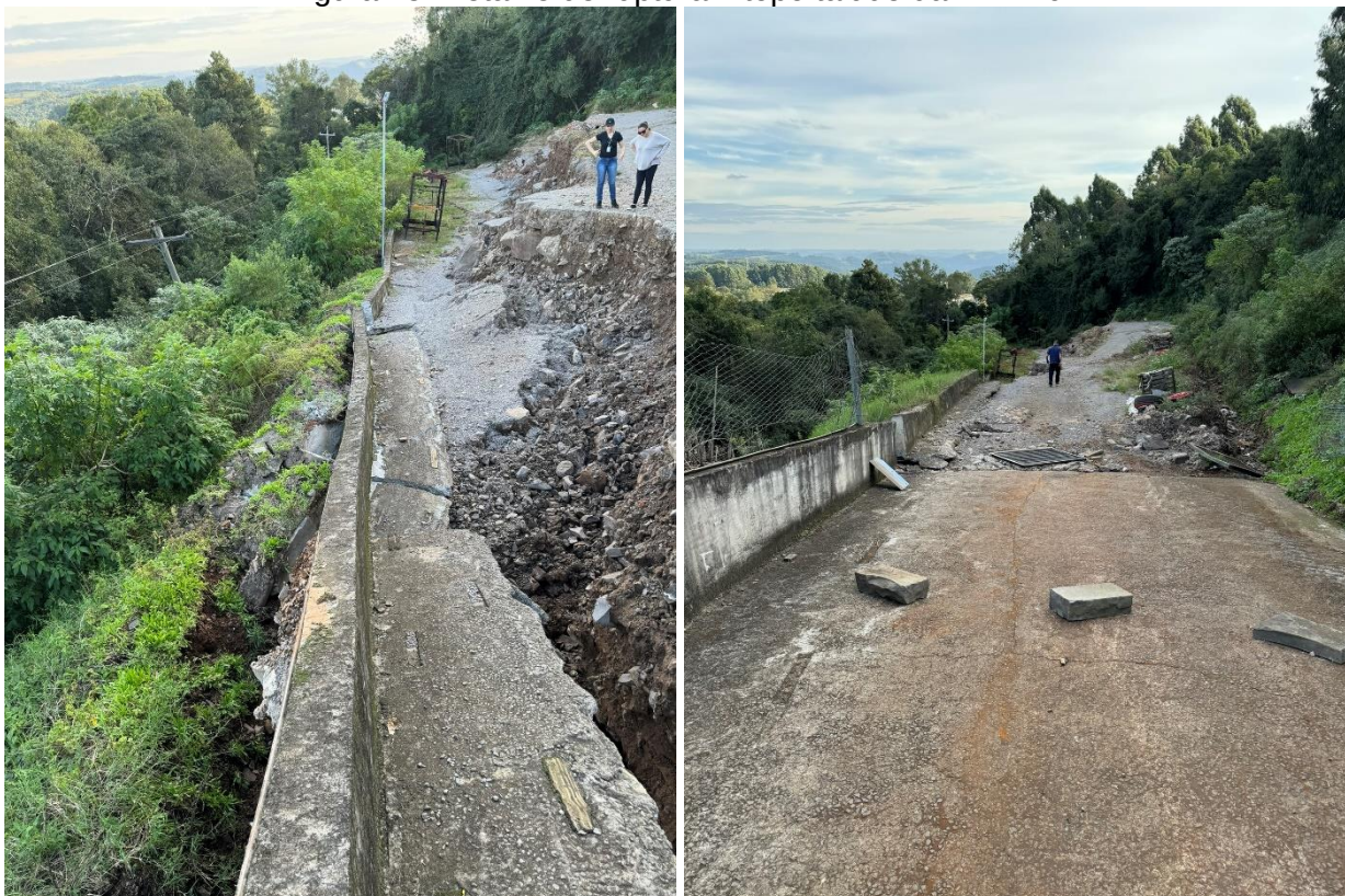
Figura 45: Detalhe de ruptura – topo talude da BR 470.
