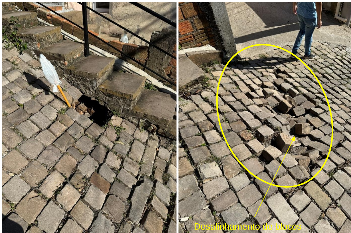
Figura 37: Detalhe de desalinhamento de blocos devido a fluxo superficial de água em rua do Bairro Santo Antônio.
