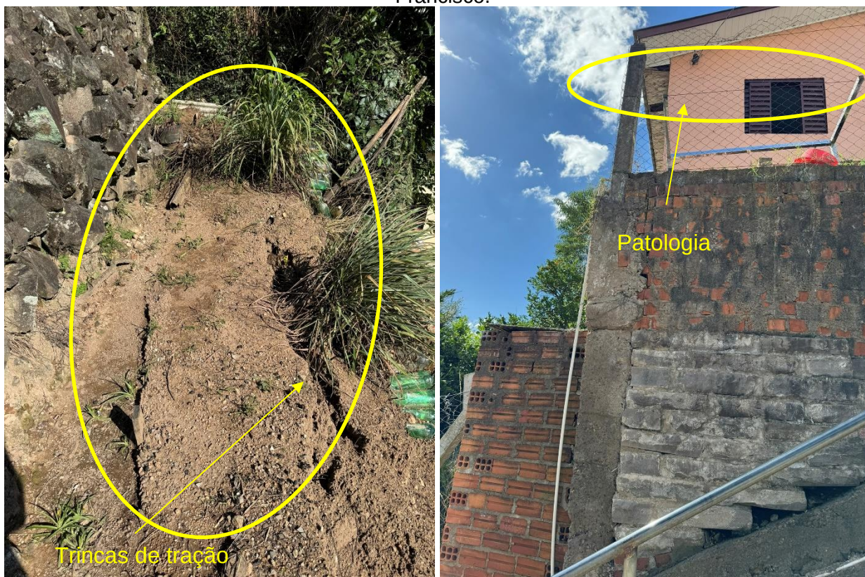
Figura 22: Detalhe de trincas de tração em solo e patologia em residência do Bairro São Francisco.
