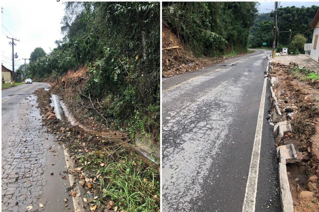
Figura 66: Detalhe de deslizamentos na Estrada de Santa Bárbara.
