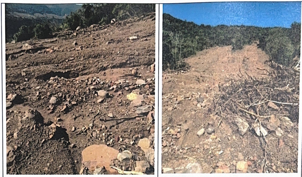
Foto 3 e 4. Parreiral, Pomar de Citros, olericultura atingido por deslizamento. Propriedade de Jair Rustick. Comunidade de Nossa Senhora da Glória – Veranópolis/RS.
